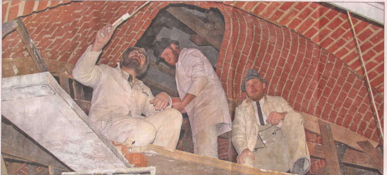
Johannes Pöllet, Kai Deters und Martin Jost bei der Arbeit. In der alten Windberger Scheune soll Gewölbe neben Gewölbe entstehen. Zum Ende der Woche soll das zweite Bauwerk vollendet sein, wann das dritte nebdan entstehen wird, ist aber noch unklar. Am Ende soll aber die gesamte Grundfläche bedeckt sein. Fotos (2): Wagner
